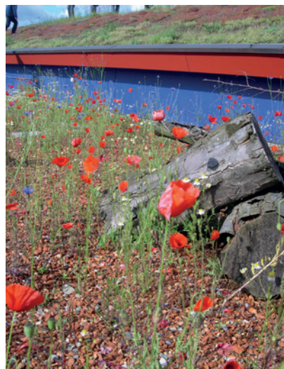
Tonnen- und Flachdachbegrünung eines Gewerbebaus
